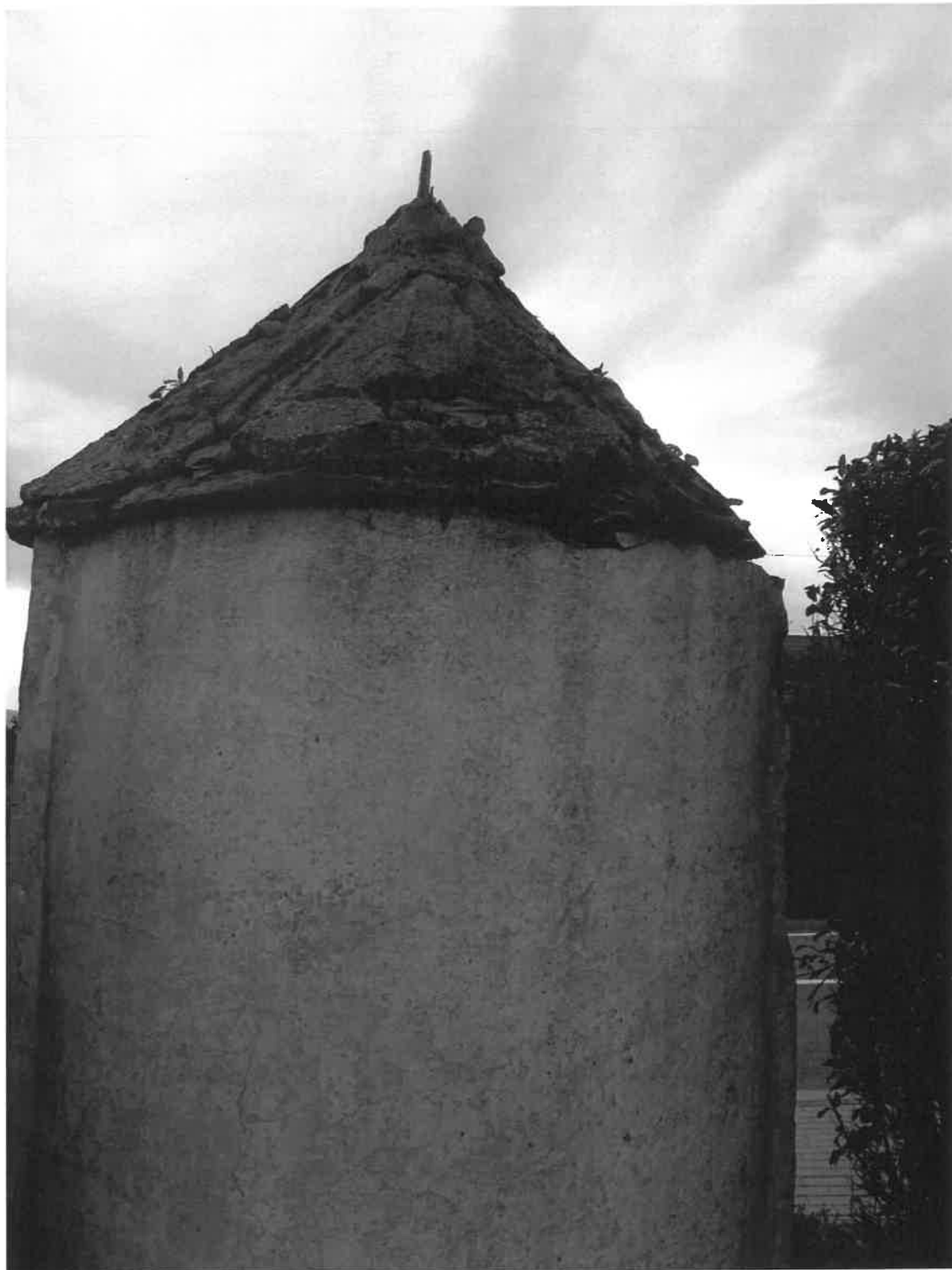
Fot .7 .Kapliczka w Siedliskach; Widok tyłu kapliczki- widoczne zniszczenia kamiennego dachu .2019
