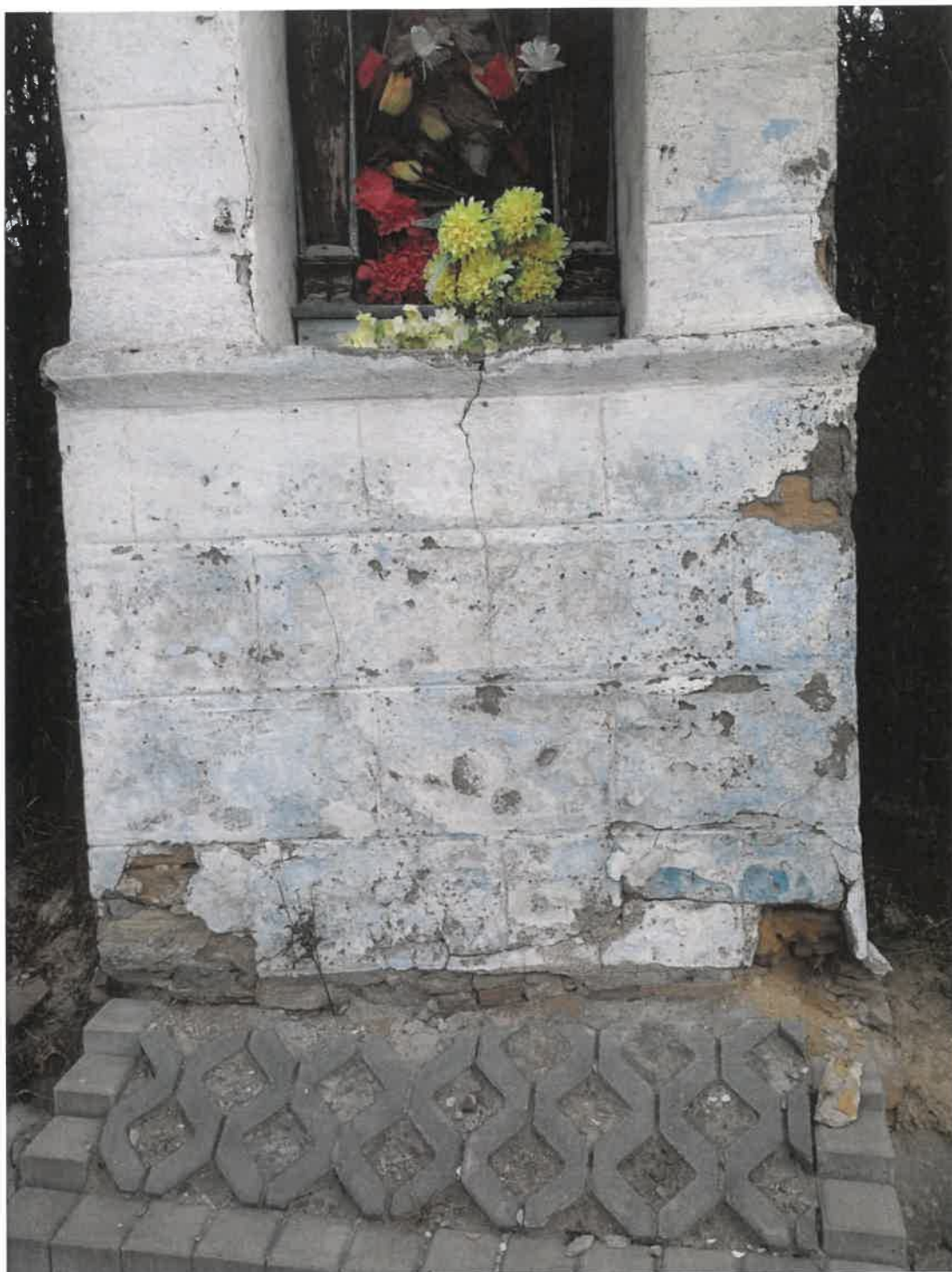
Fot.4 .Kapliczka w Siedliskach; widoczne zniszczenia dolnych partii wypraw i wążku kammiennego .2009.
