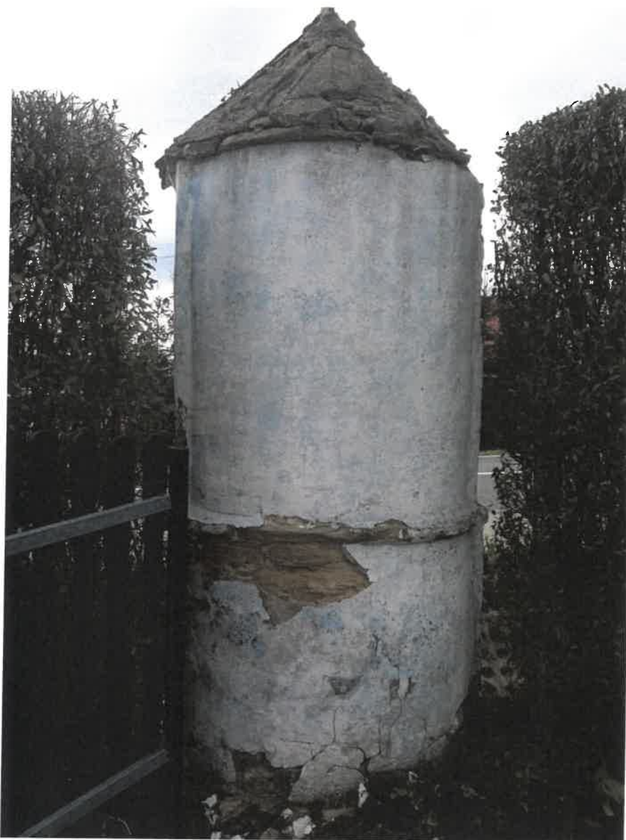
Fot.10 .Kapliczka w Siedliskach; Widok tyłu kapliczki- widoczne zniszczenia dolnych partii oraz kamiennego dachu .2019
