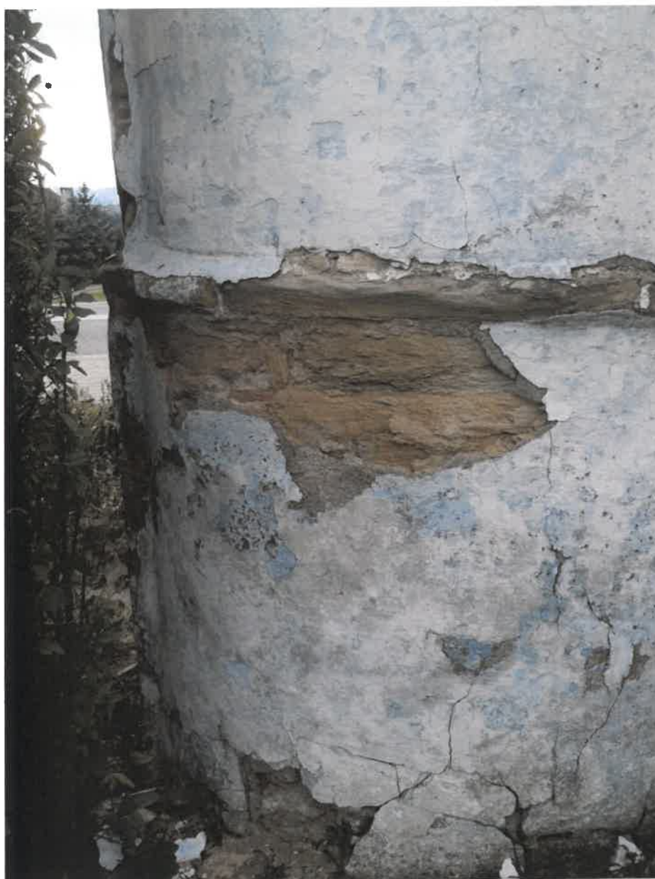
Fot.8 .Kapliczka w Siedliskach; Widok tyłu kapliczki- widoczne zniszczenia dolnych partii kapliczki.2009
