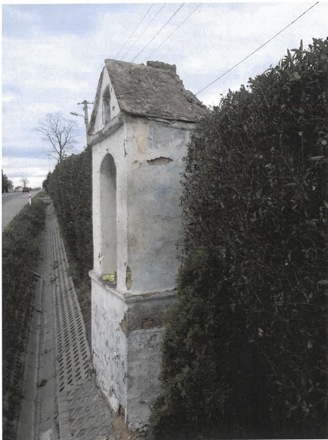
Fot.2 .Kapliczka w Siedliskach; widok ogólny . Bliskość ruchliwej drogi jest przyczyną wielu zniszczeń.2019
