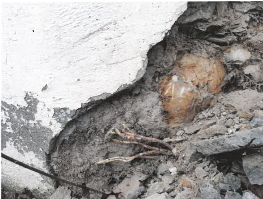
Fot.6 Kapliczka w Stróżnej .W odkrywce pod warstwą betonu widoczne historyczne pobiały oraz wętek kamienny. Stan ;Listopad 2019
