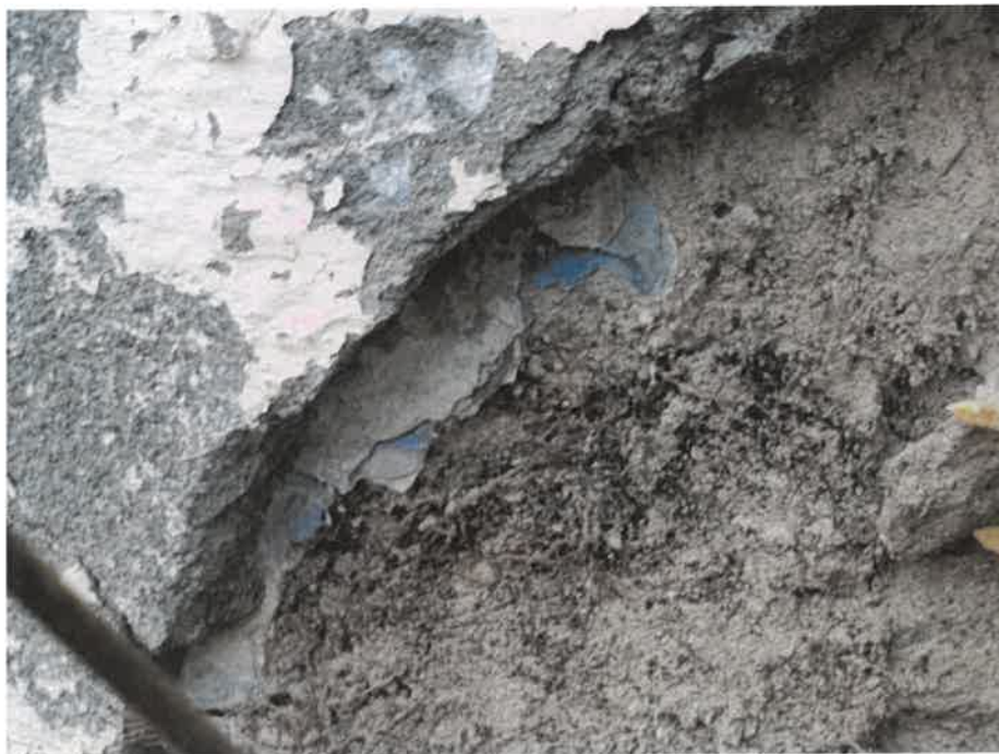
Fot.7 Kapliczka w Stróżnej .W odkrywce pod warstwą betonu widoczne historyczne pobiały oraz wętek kamienny. Stan ;Listopad 2019
