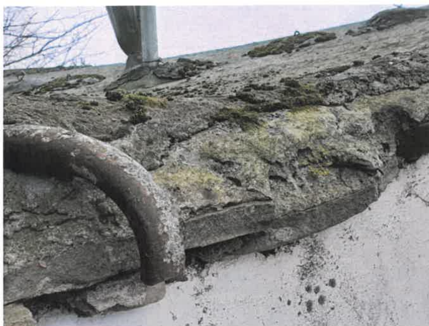
Fot.5 Kapliczka w Stróżnej .Widok na dach . Na kamiennych płytach położona warstwa betonu. Stan ;Listopad 2019
